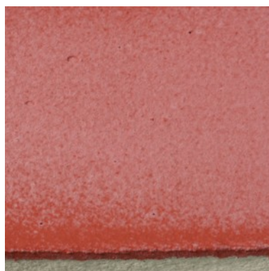
Fig. 2 Enduit d'apprêt sans ERASEAL120 après test, avec une forte efflorescence et aucune propriété hydrophobe
